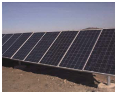
Paneles solares con seguimiento en un eje
