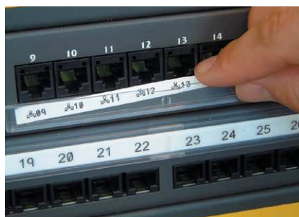
Etiquetas bloques de cableado
