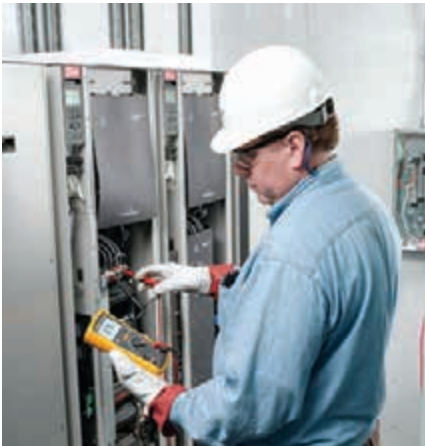
Un megóhmetro se puede usar para tomar lecturas de resistencia de aislamiento en sistemas y equipo eléctrico.
