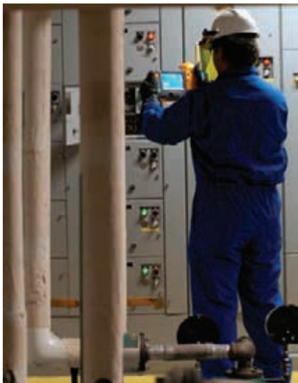
Las cámaras termográficas se pueden usar para detectar de forma segura los problemas inadvertidos con el equipo y los sistemas eléctricos.
