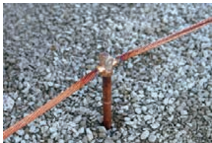
Los sistemas de conexión a tierra comerciales pueden tener alambre de cobre o con chapa de cobre soldados a varillas de tierra de cobre o con chapa de cobre.
