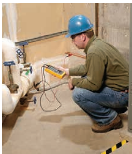
Las medidas de resistencia de tierra pueden tomarse en tubos de agua metálicos según sea necesario.
